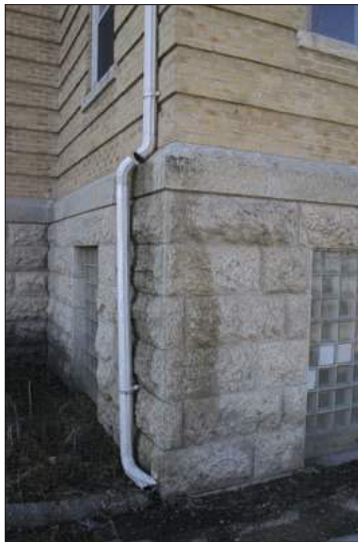
Ce tuyau de descente s'est détaché entre le premier et le deuxième étage, ce qui le rend totalement inefficace. Il lui manque aussi une descente pluviale pour éloigner l'eau du bâtiment, ce qui peut endommager les fondations.
