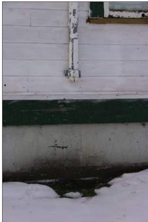
À cause d'un tuyau de descente manquant et du mauvais nivellement du sol, l'eau s'accumule à la base du bâtiment et peut causer de gros dégâts.
