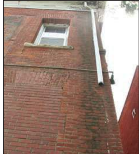
Le tuyau de descente manquant est à l'origine d'un dépôt sur le mur extérieur. Le nettoyage risque d'aggraver les dommages et il est peut-être préférable de laisser le mur tel quel.
