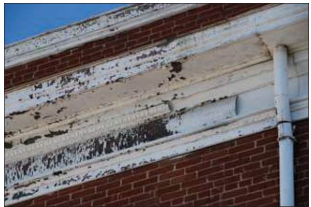
L'application d'une bonne couche de peinture pourrait améliorer le détail architectural et l'apparence générale de ce site.
