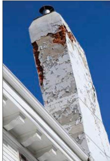
La cheminée a été négligée pendant de nombreuses années. Un maçon doit la reconstruire avec de nouvelles briques en raison du degré de détérioration.
