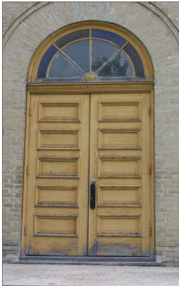
Cette porte a besoin d'une nouvelle couche de peinture pour préserver son intégrité. Il faut aussi en inspecter le bourrelet de calfeutrage.
