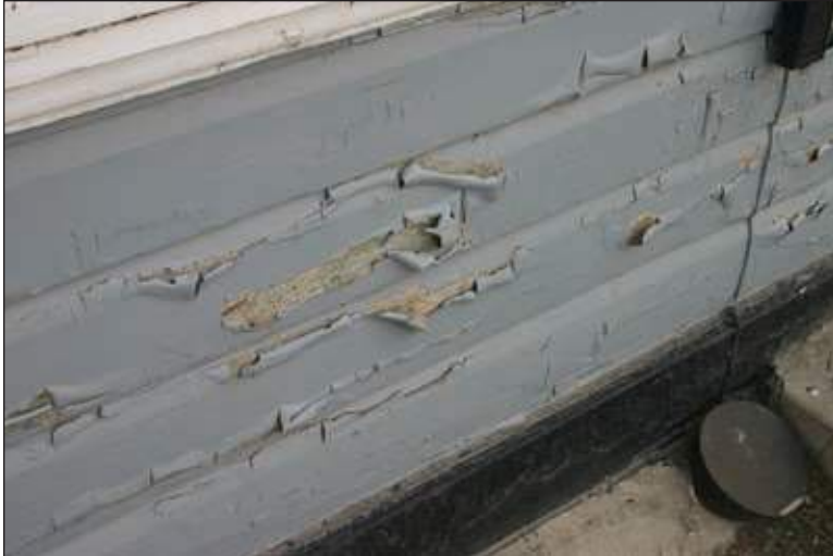
La peinture écaillée est souvent un signe de dommages causés par la chaleur ou par l'eau. Le meilleur traitement consiste à enlever autant de peinture friable que possible, à déterminer si la couche existante est une peinture à l'huile ou au latex, à étendre un apprêt extérieur de qualité et à appliquer une nouvelle couche de peinture.
