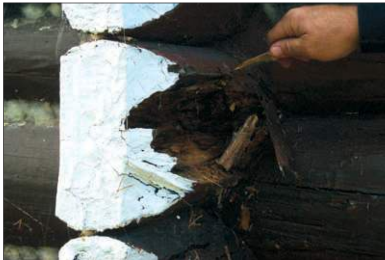
Ce rondin a été endommagé par l'eau. Cherchez d'où provient cette eau et remédiez à la cause de la détérioration avant de remplacer le rondin.
