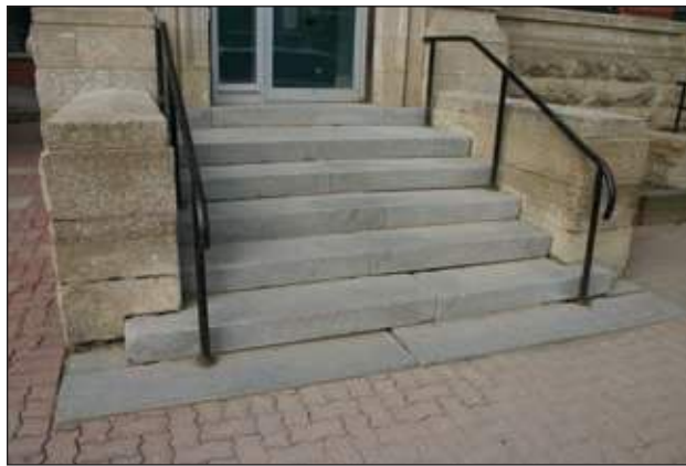
Il faut inspecter ces marches, car le gel et le dégel les font se soulever. Un maçon devra peut-être les remettre à niveau.
